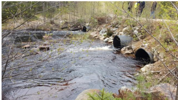
De gamla vandringshindrande vägtrummorna
